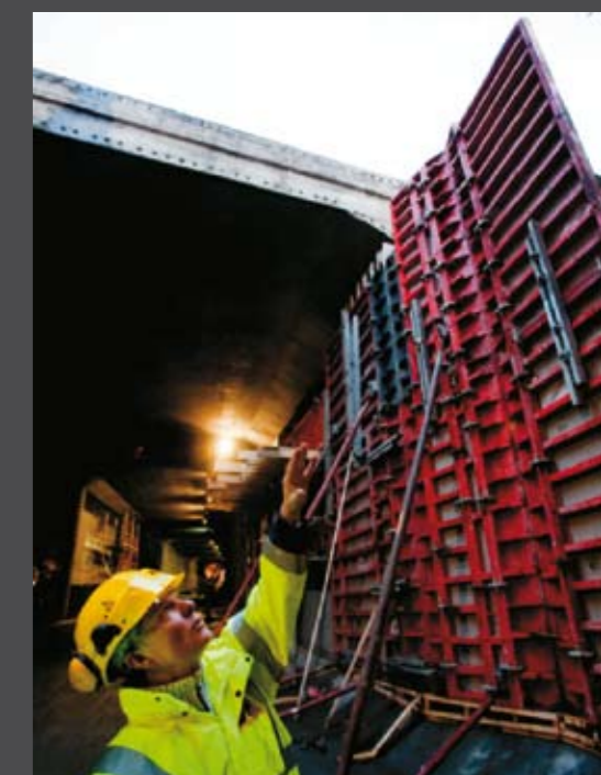
Betongteknolog Bernt Kristiansen fra Teknisk kompetansesenter i AF forklarer hvordan det støpes i tunnelen på Sørenga. Foto: Morten Brakestad
